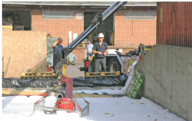
Etwa 2000 Kubikmeter Schaum und Wasser pumpt die Feuerwehr ab.
